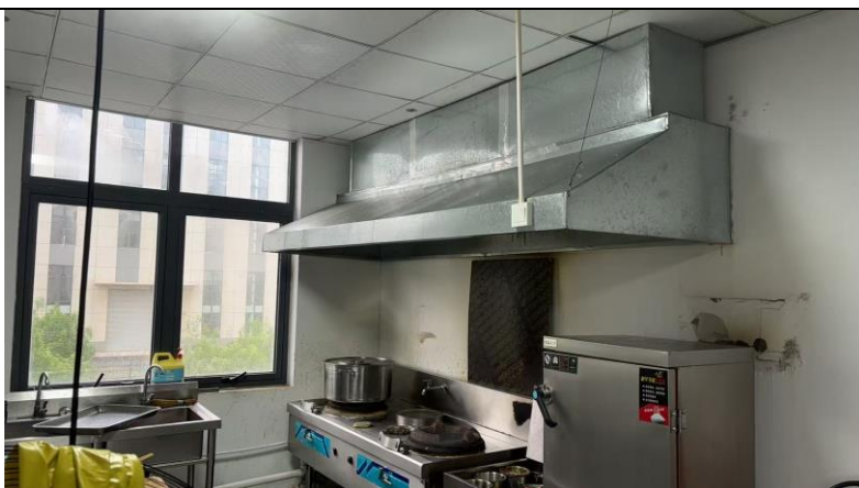
图 3-2 (d) 油烟废气收集治理设施
