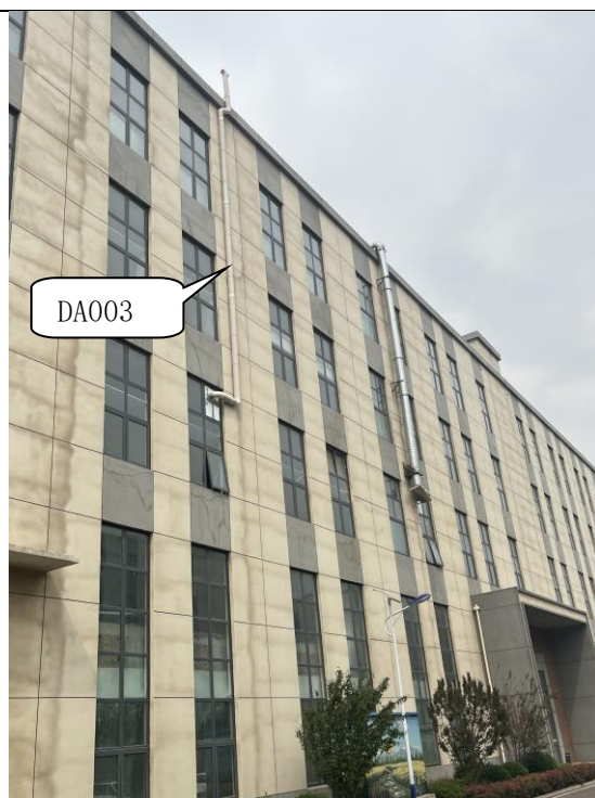
图 3-3(c) DA003 油烟废气排气筒
