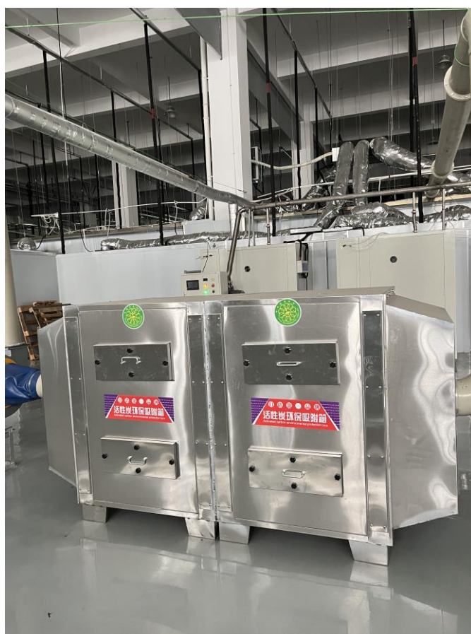
图 3-2 (c) 注液工序废气治理设施
