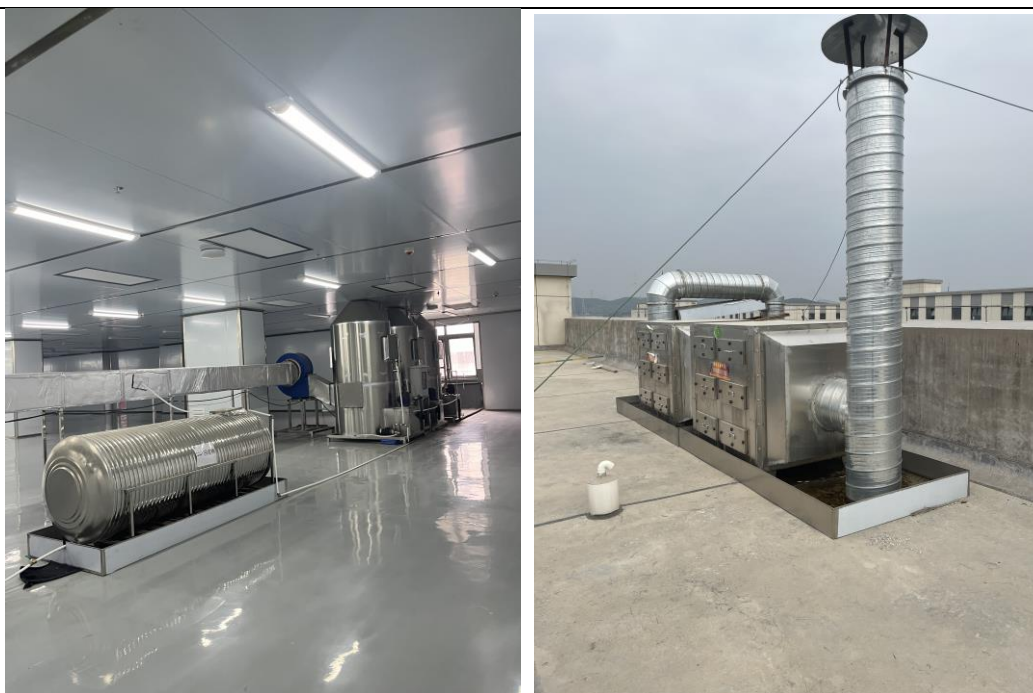
图 3-2 (b) 涂布烘干废气治理设施
